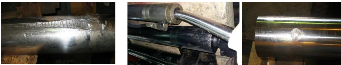
Рис. 2 Примеры дефектов штока
