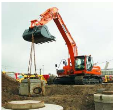
Рис. 1. Нарушение техники безопасности
