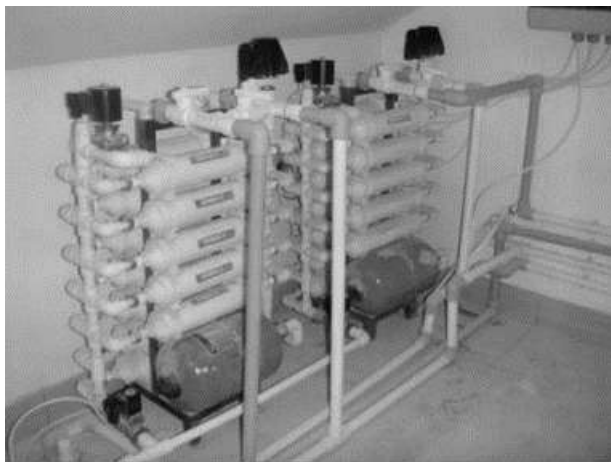
Рис. 2. Установки ультраfiltrации для очистки горячей и холодной воды в жилых зданиях
