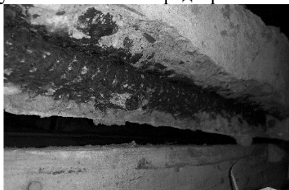
Рис. 1. Повреждение периодического профиля арматуры
