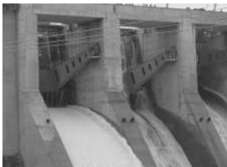
Рис. 2. Сегментные затворы водосливной плотины гидроузла Капанда (Ангола)
