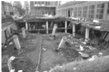
Рис.1. Обрушение перекрытия подземной автостоянки, г. Москва
