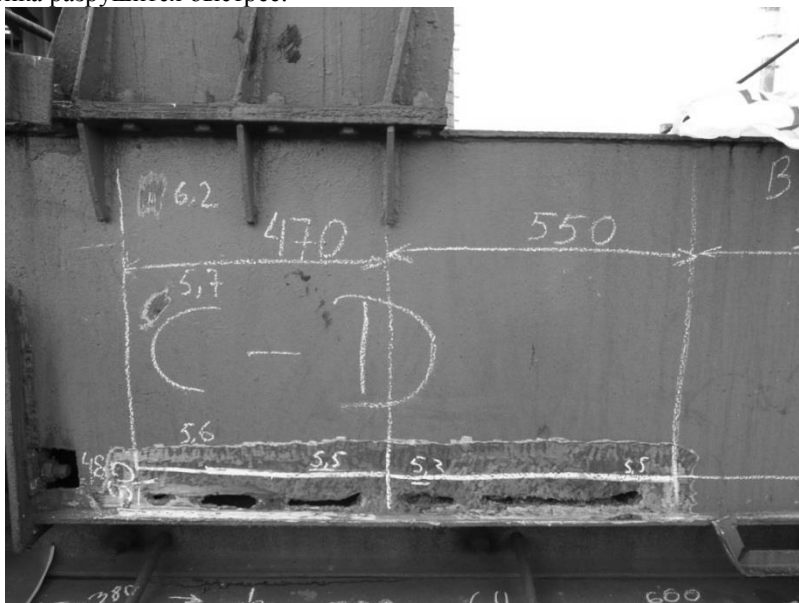
Рис. 1. Сквозное коррозионное разрушение стяжки козлового крана
