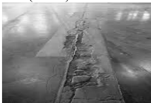
Рис.2. Выбоины на поверхности бетонного покрытия
