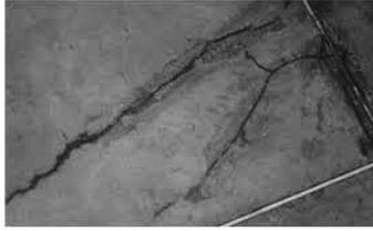
Рис.4. Откол угла плиты
