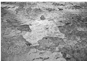
Рис.1. Шелушение бетонного покрытия
