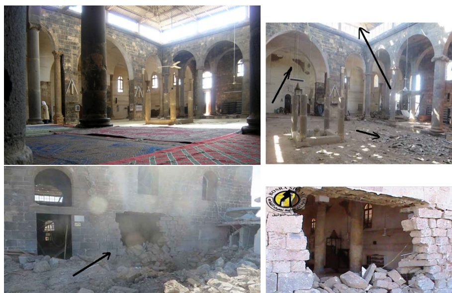
Рис. 4 – Повреждения строительных конструкций в Мечети Омара в г. Босра в Сирии: а – внутренний двор мечети до войны; б – разрушения во внутреннем дворе мечети в результате войны; в – разрушения на фасаде мечети; г – разрушения на фасаде мечети (крупным планом); д – минарет мечети до войны; е – повреждения на северной стороне стены и минарета
