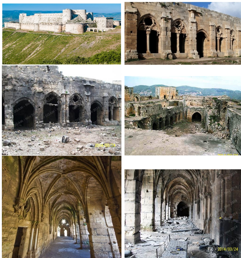
Рис. 1 – Повреждения строительных конструкций в замке Крак де Шевалье в Сирии в результате военных действий:
