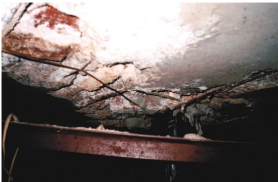
Рис.1. Разрушение ж/б междуэтажных перекрытий
