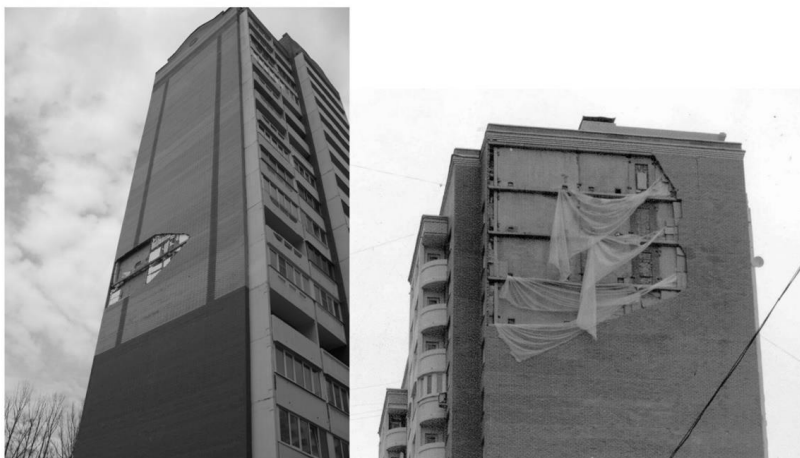
Рис. 1. Общие виды стен жилых домов после обрушения участка облицовочного слоя
