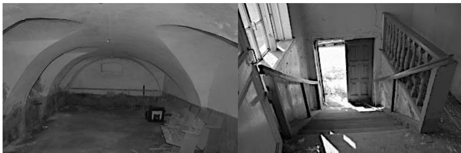
Рис. 3. Внутреннее состояние объекта (лето 2016 г.).
