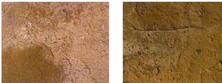
Рис.3. Разрушение бетонных конструкций в результате углекислотной коррозии
