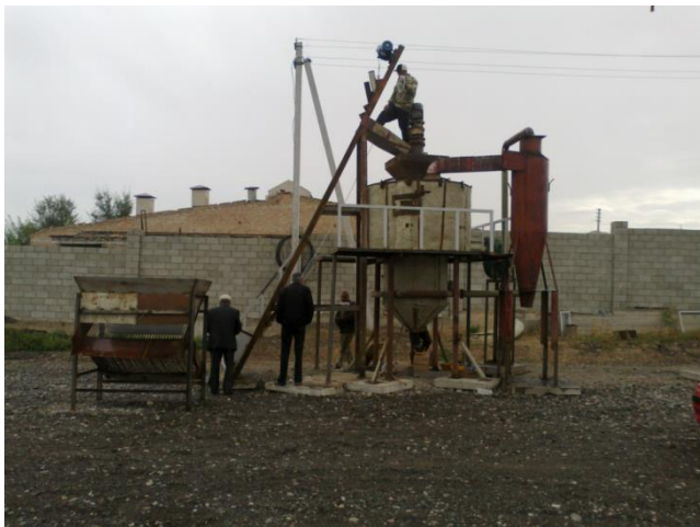
Рис. 3. Общий вид мини - углеперерабатывающего комплекса
